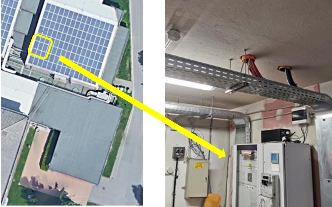
Figure 10.3 - Locale Quadri elettrici della struttura
