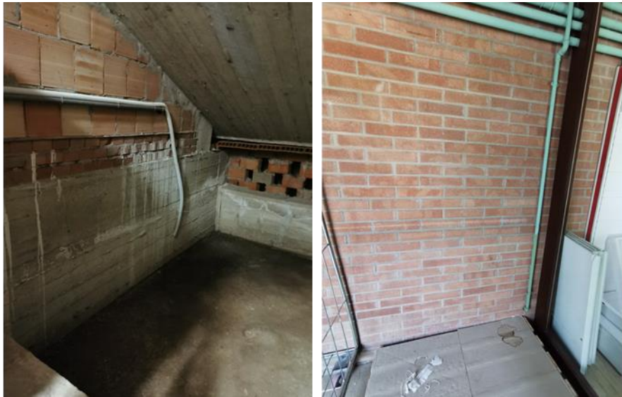
Figure 4.3 Punto di attraversamento su muratura di separazione tra centrale termica e locale adiacente con passaggio a pavimento
