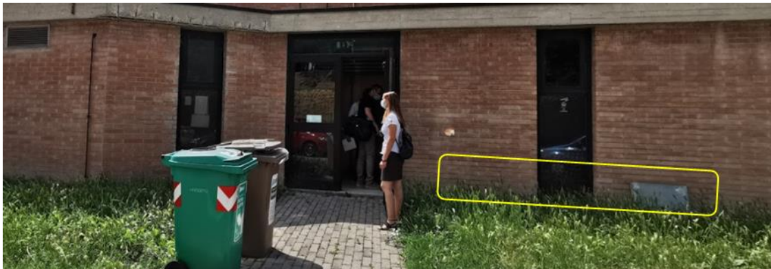
Figure 4.4 Parete in corrispondenza dell'uscita delle tubazioni mandata e ritorno delle varie linee di impianto
