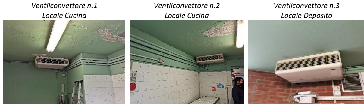
Figure 2.7 - Immagini dei ventilconvettori attualmente installati presso il sito
