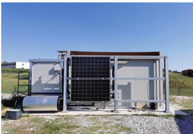
Figura 1.1. Impianto pilota presso il laboratorio TekneHub (WP3)
