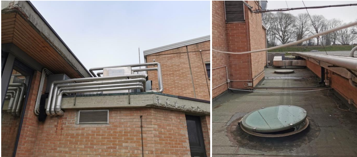
Figure 2.9 - Sviluppo dello stacco dalla rete di distribuzione a servizio della climatizzazione del bar e dei locali accessori
